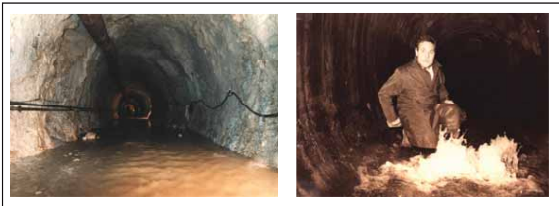
31 - Tratto drenante della sorgente Baiardo Montemarano
